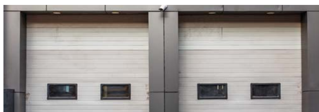
PORTONES DE ESTACIONAMIENTOS
