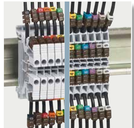
Señalización con CAB 3 (Marcador para cable y clemas).
