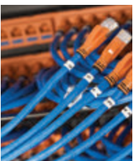
Conexión de routers y servidores
