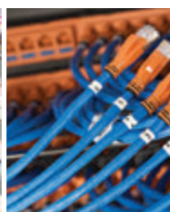
Conexión de routers y servidores
