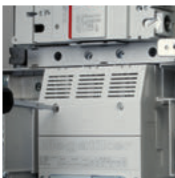
CUBIERTA AISLANTE INTERRUPTOR PRINCIPAL
