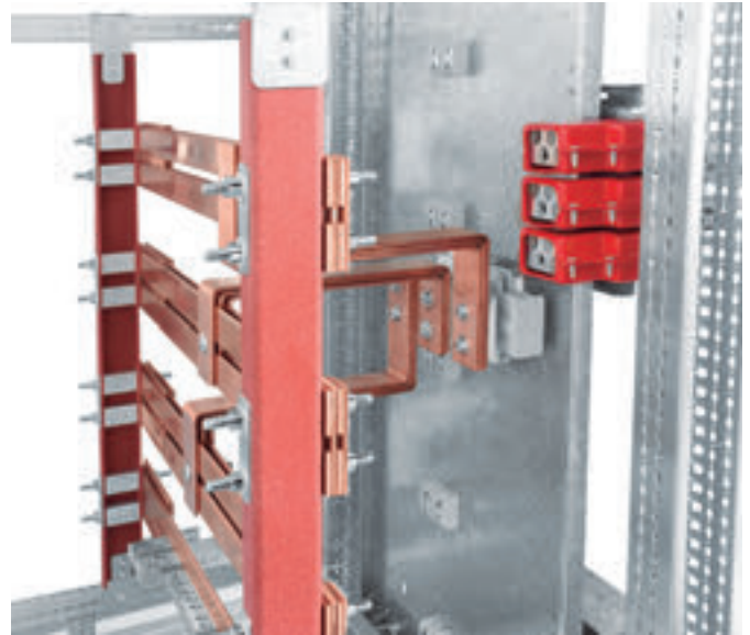
Conexión de Bus principal a sección de distribución BQD.
