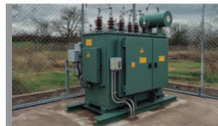
Transformadores de Pedestal
