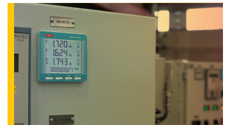
Sistemas de Medición Centralizados
